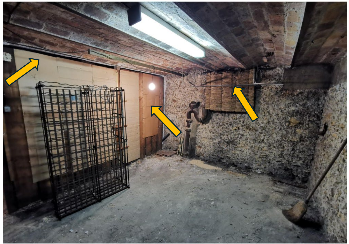
Soupirail fermé et barbacanes bouchées par cartons, porte calfeutrée
