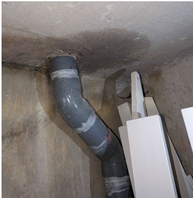
Fuite sur une descente
