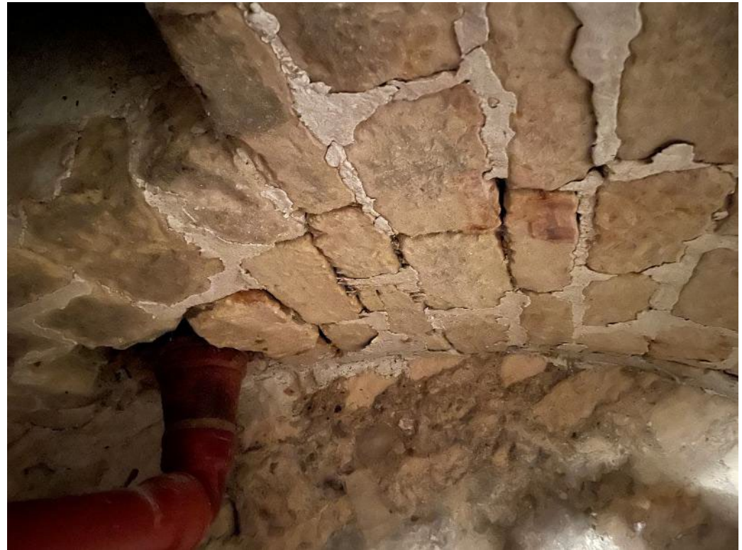
Fuite ayant déjointoyée la voûte : risque d'effondrement
